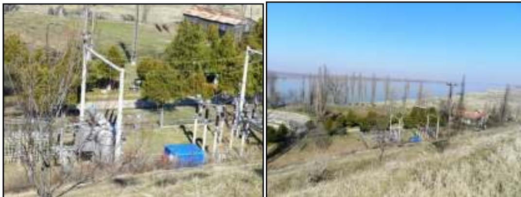
Statie transformare aferenta SPAP
